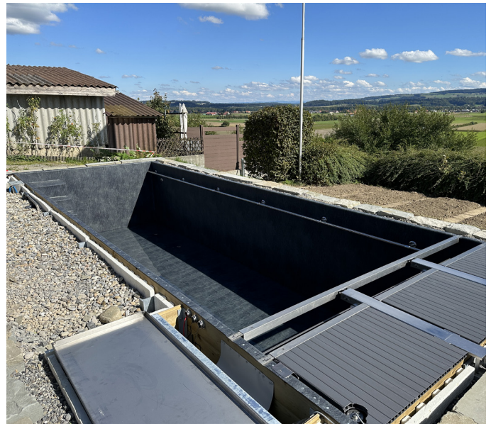
Bild 2) Pool mit allen Anschlusssteilen
